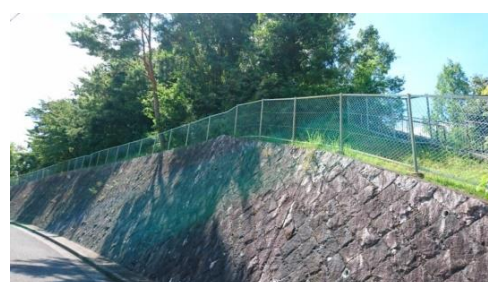
北側からハザードを撮影
